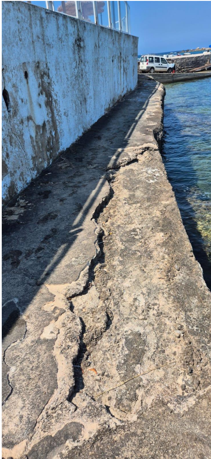
Ilustración 11: zonas con el pavimento especialmente deteriorado.
