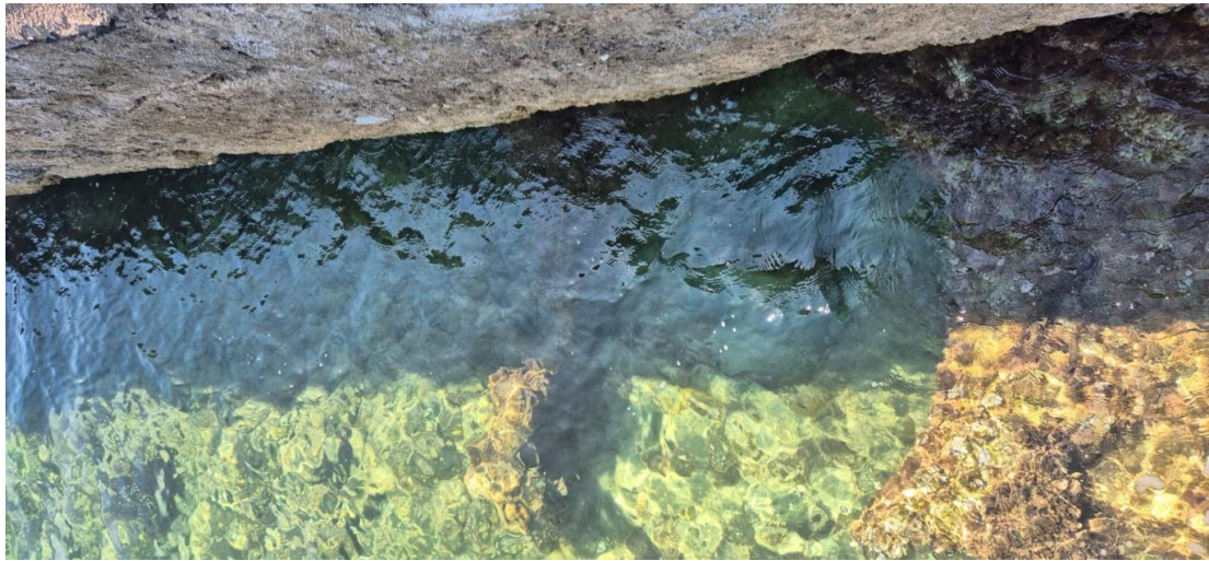
Ilustración 8: nuevamente, socavaciones a reparar.
