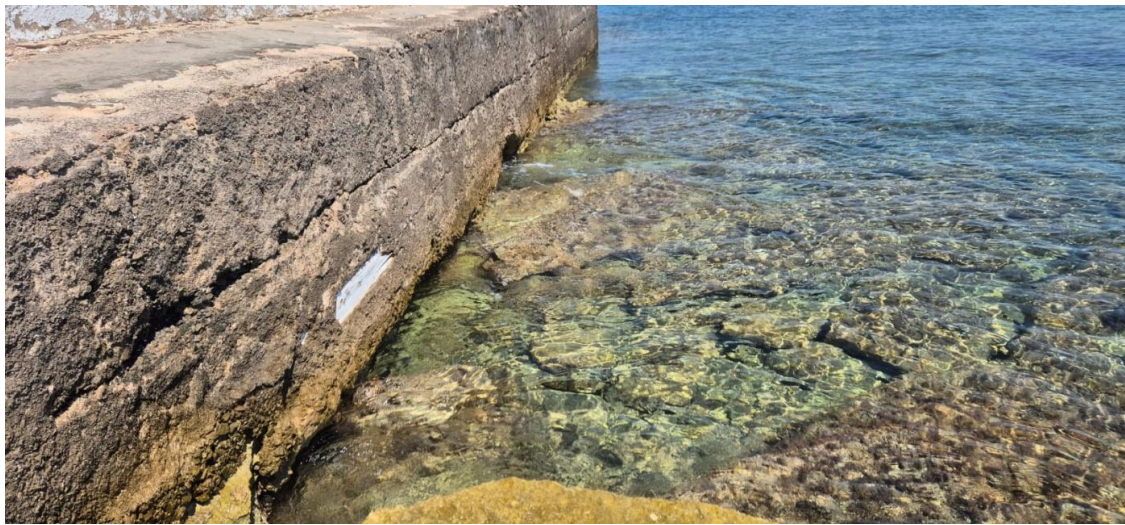
Ilustración 6: socavación y mal estado del muro. Será necesario reforzar con algo de escollera este tramo.
