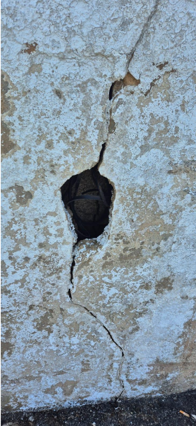
Ilustración 9: mal estado del paramento del muro.
